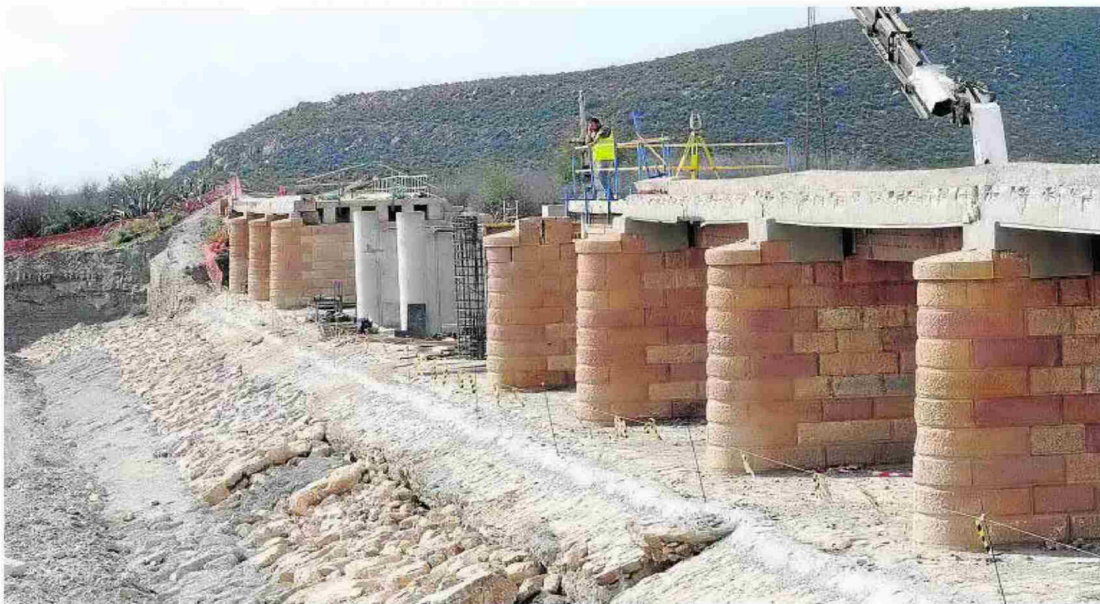
Obras de reparación de la línea ferroviaria entre Pulpí y Lorca, ejecutadas tras las riadas de septiembre de 2012. :: PACO ALONSO
