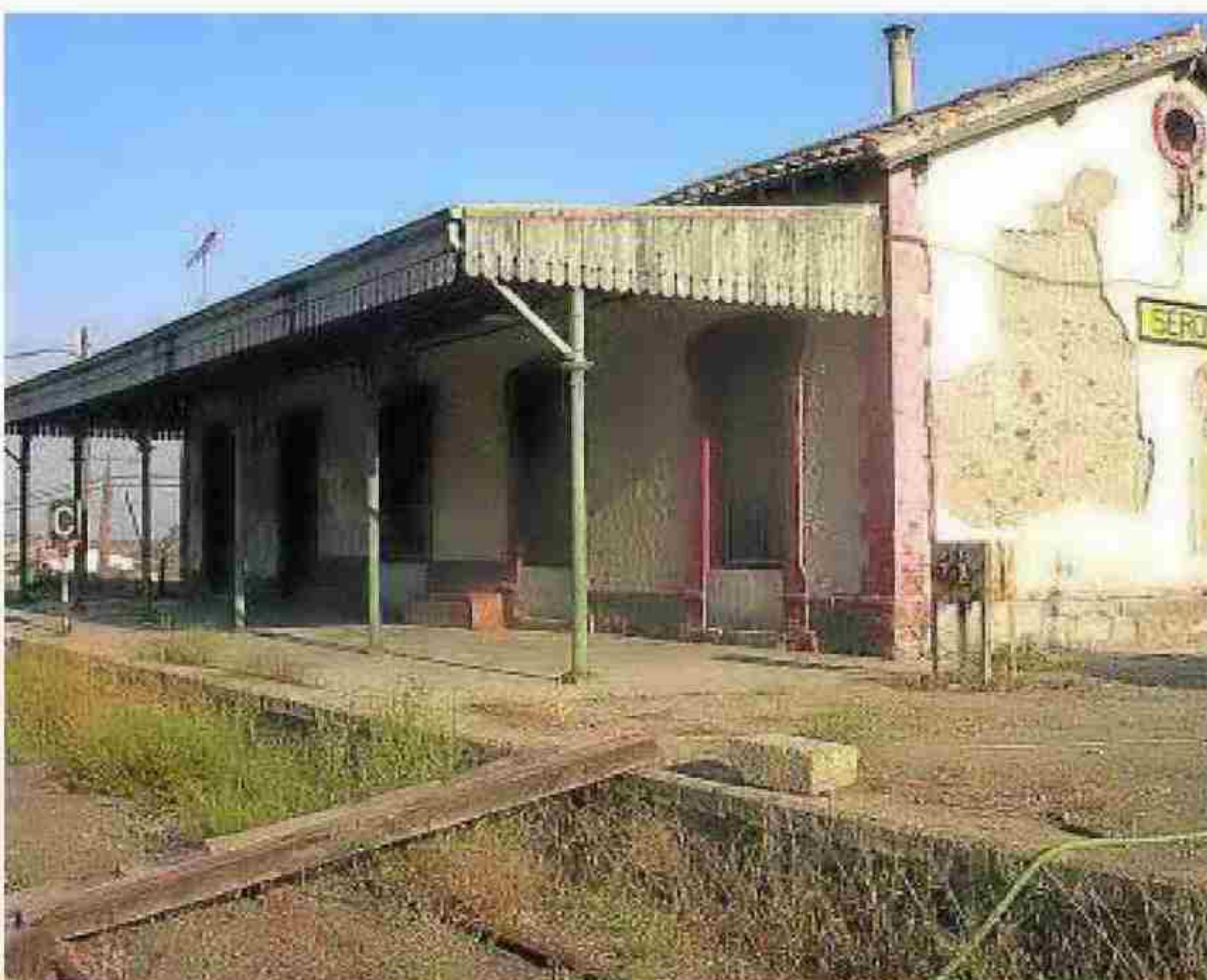
Estado de la estación de viajeros antes de su restauración. :: E. B.
