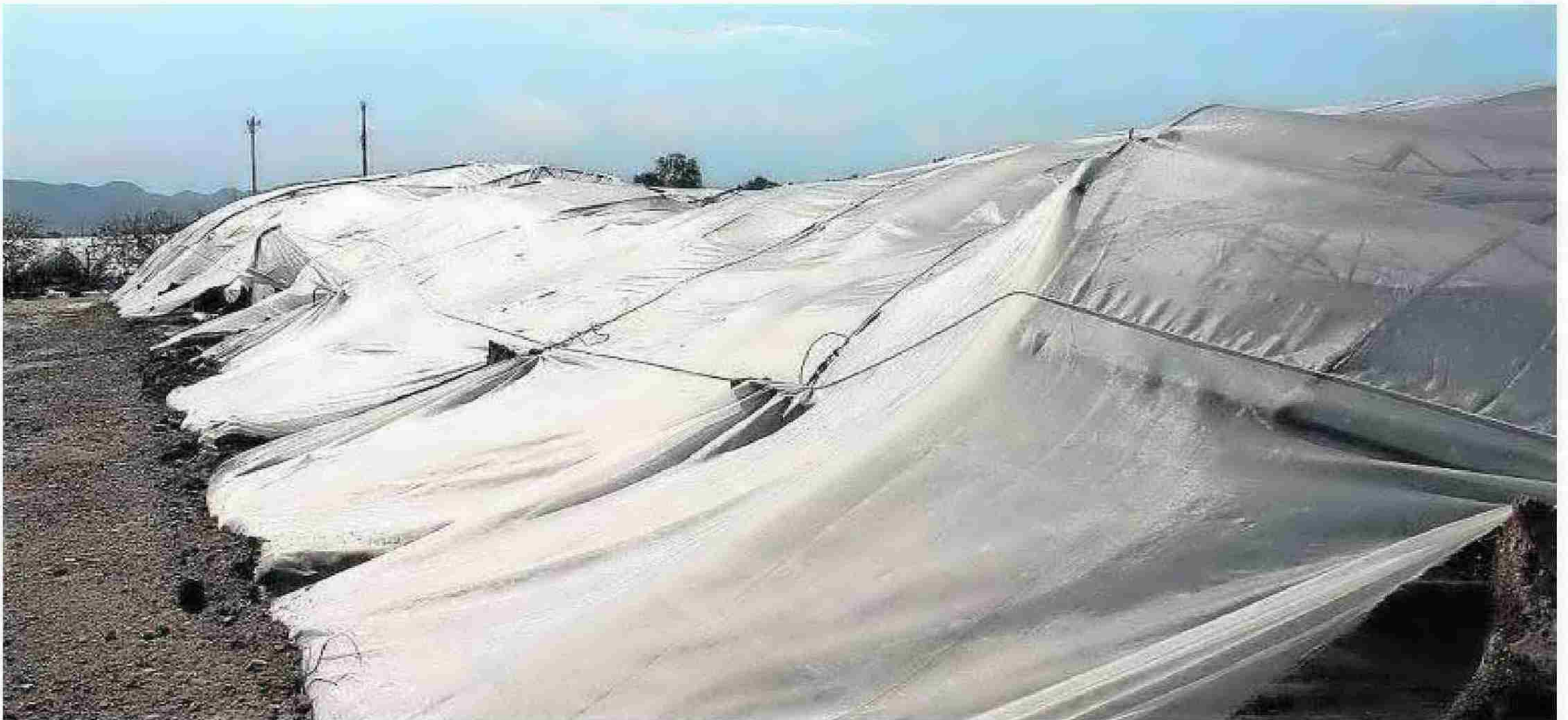
Daños ocasionados en un invernadero por la fuerza de un temporal de viento. :: IDEAL
