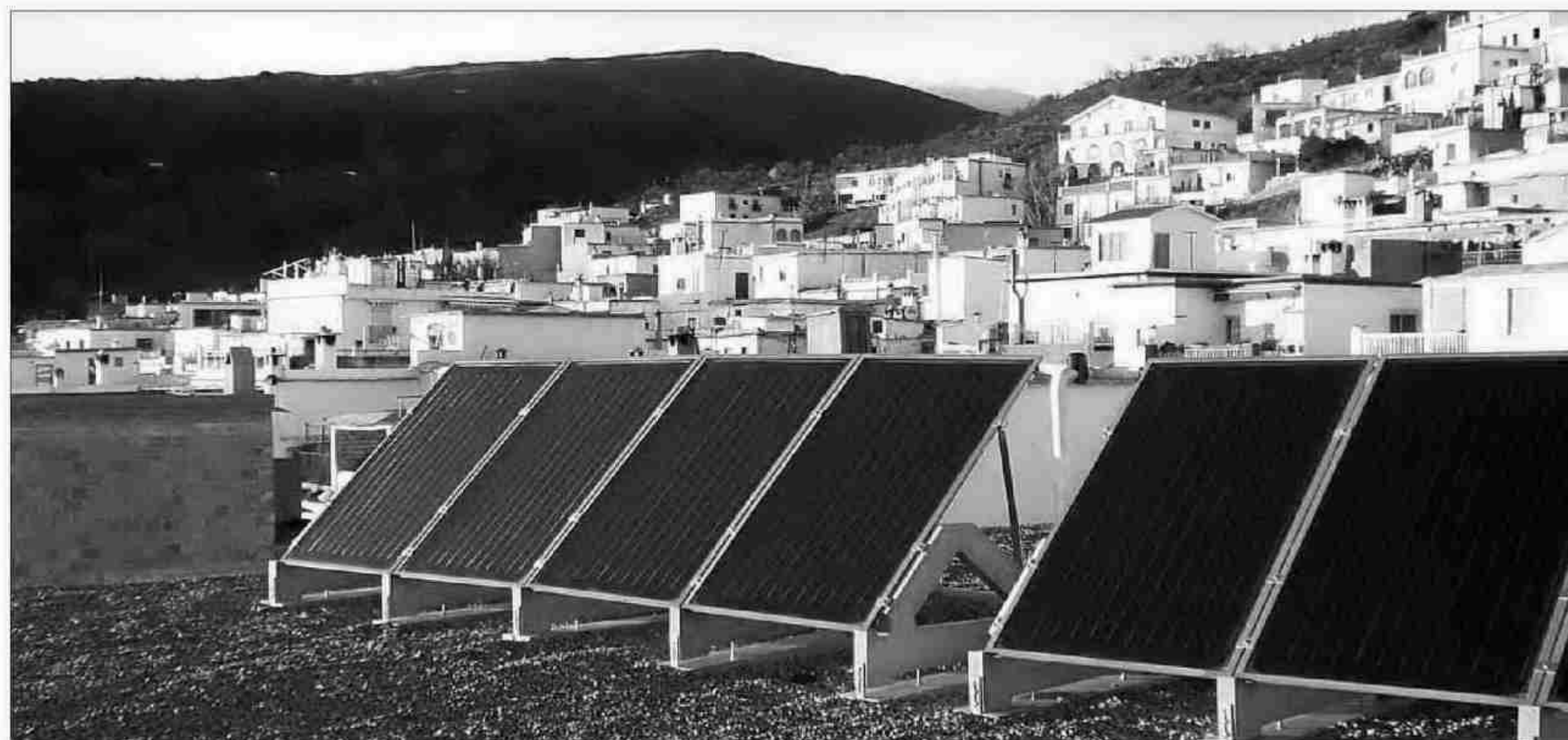
■ Placas solares encima de una vivienda de un pueblo de Almería. / LA VOZ
