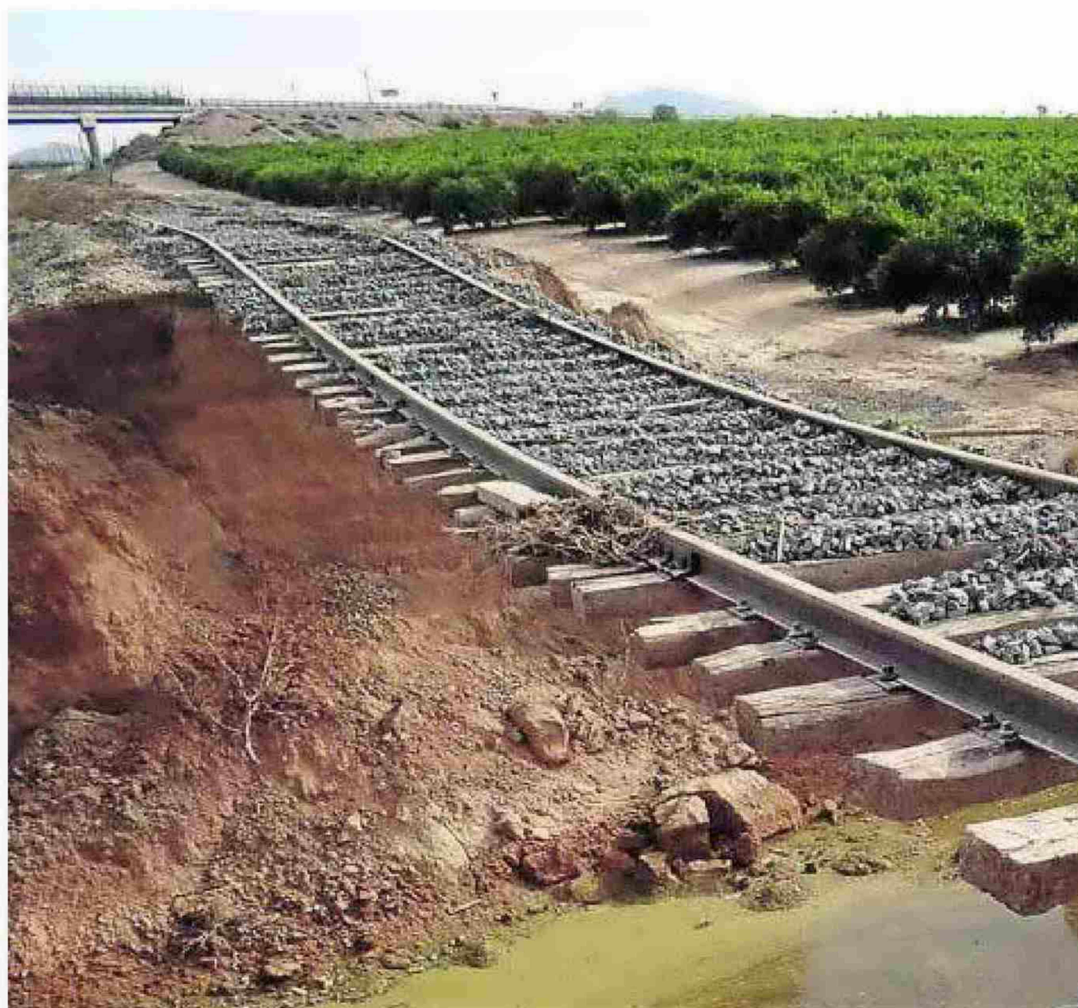
Consecuencias del fuerte temporal de lluvias torrenciales en la vía de tren que enlaza Almendricos y Águilas
