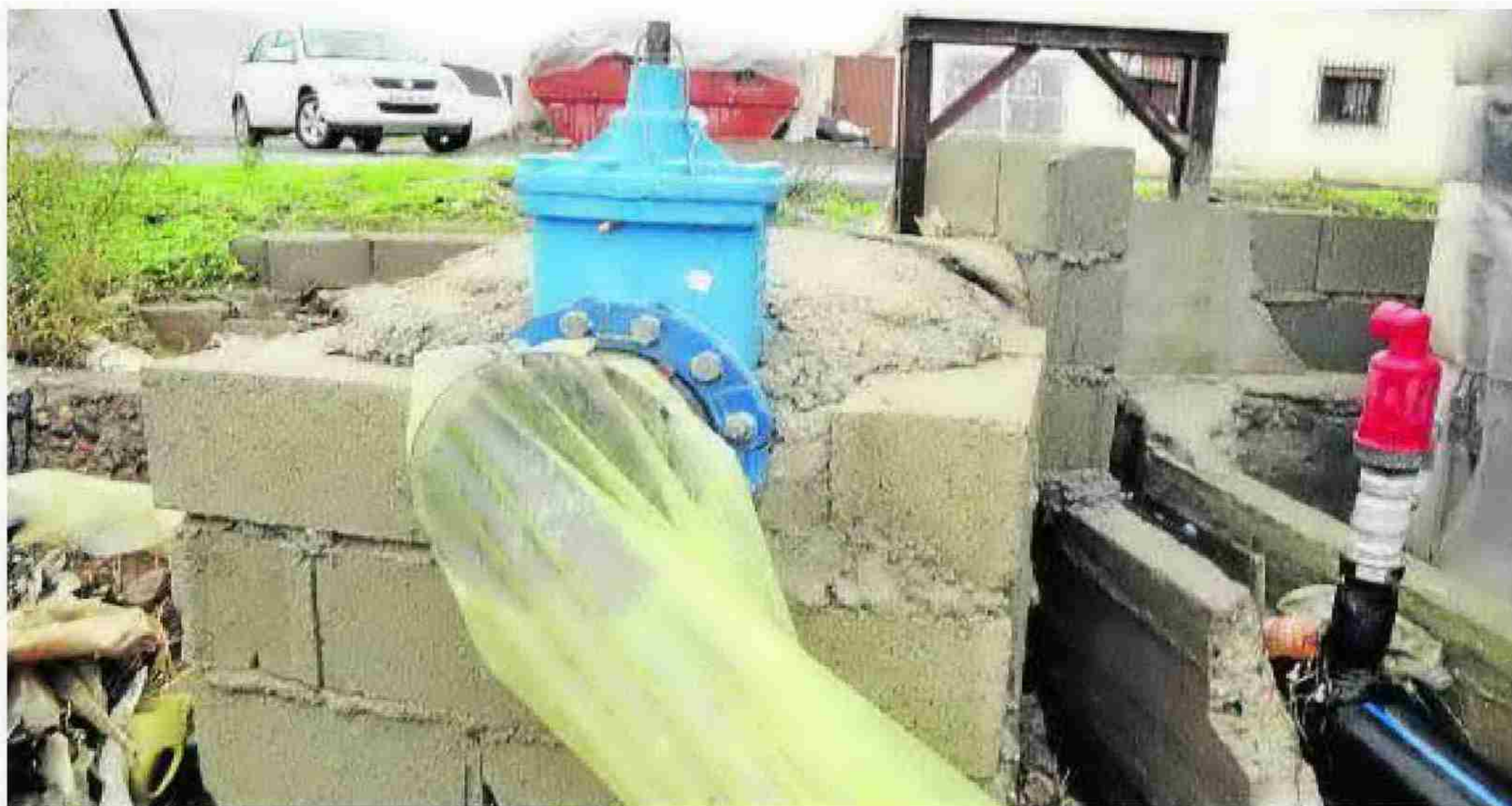
Ramal de impulsión de la balsa del Sapo, con una manguera instalada sin autorización. :: IDEAL
