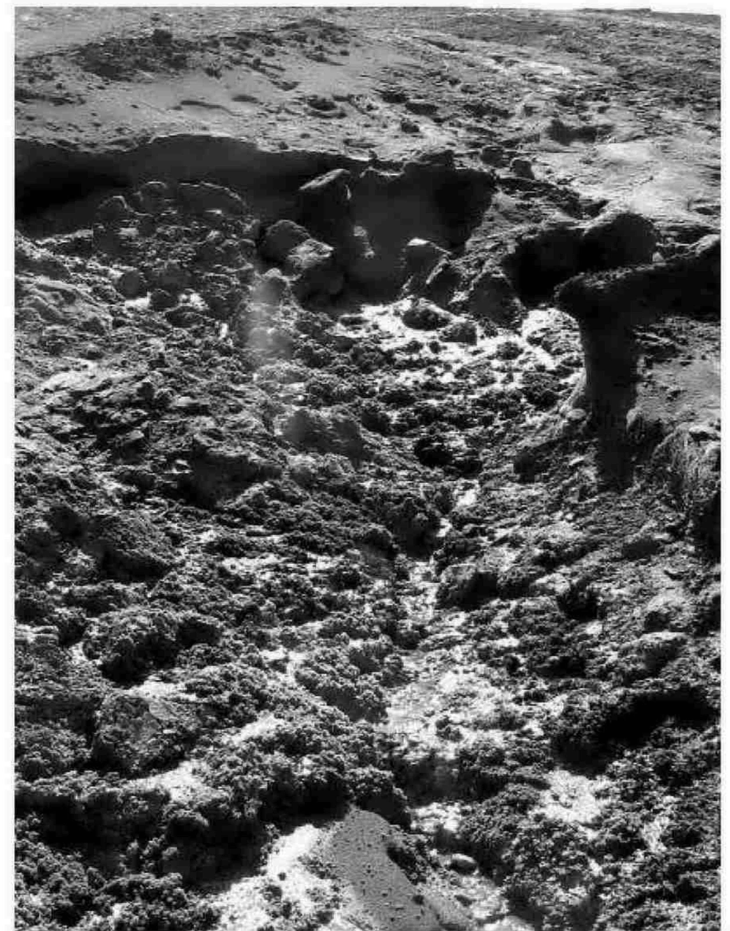
FILTRACIONES Y CÁRCAVAS EN EL MURO
