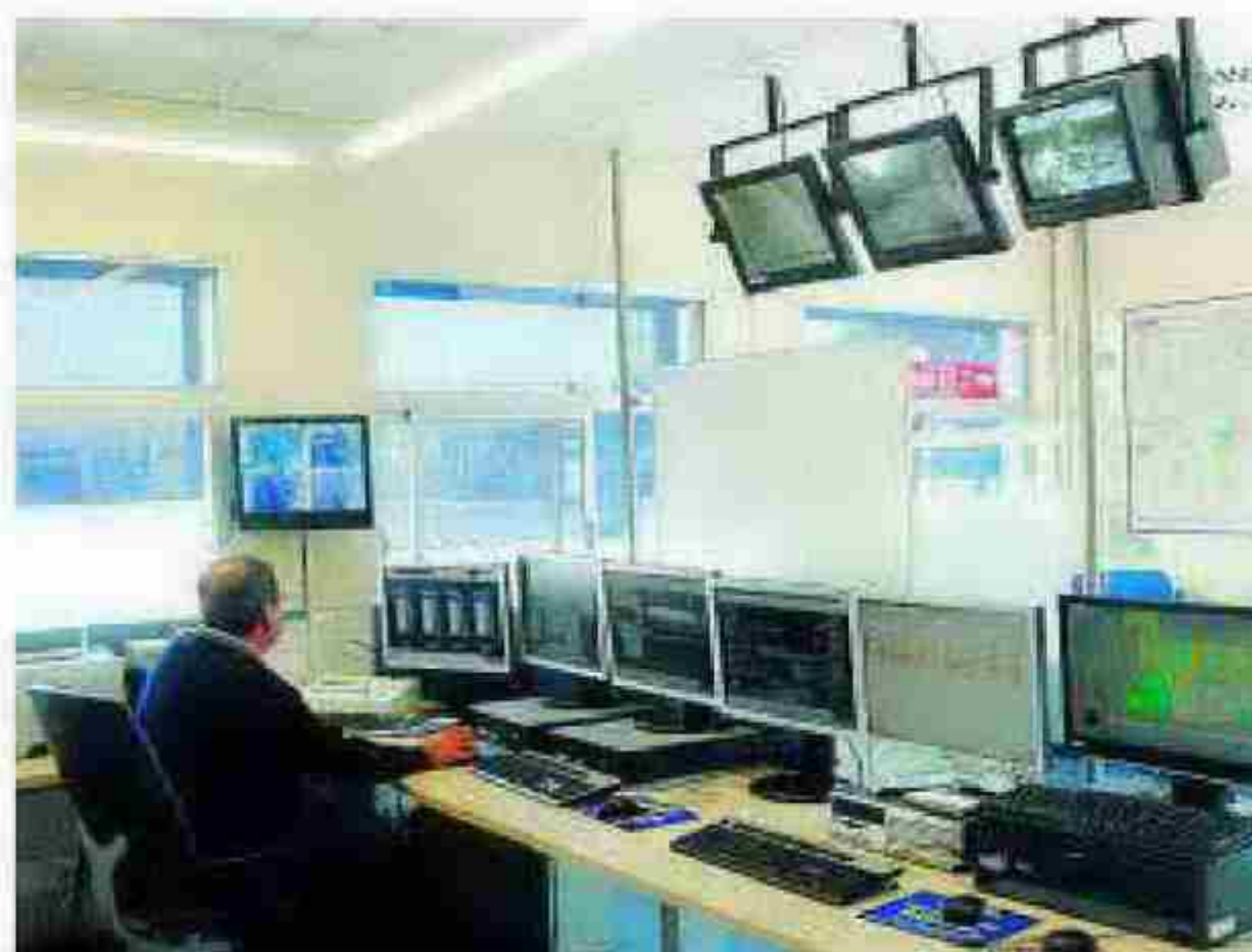
Sala de control de las instalaciones. :: J. MARTÍN
