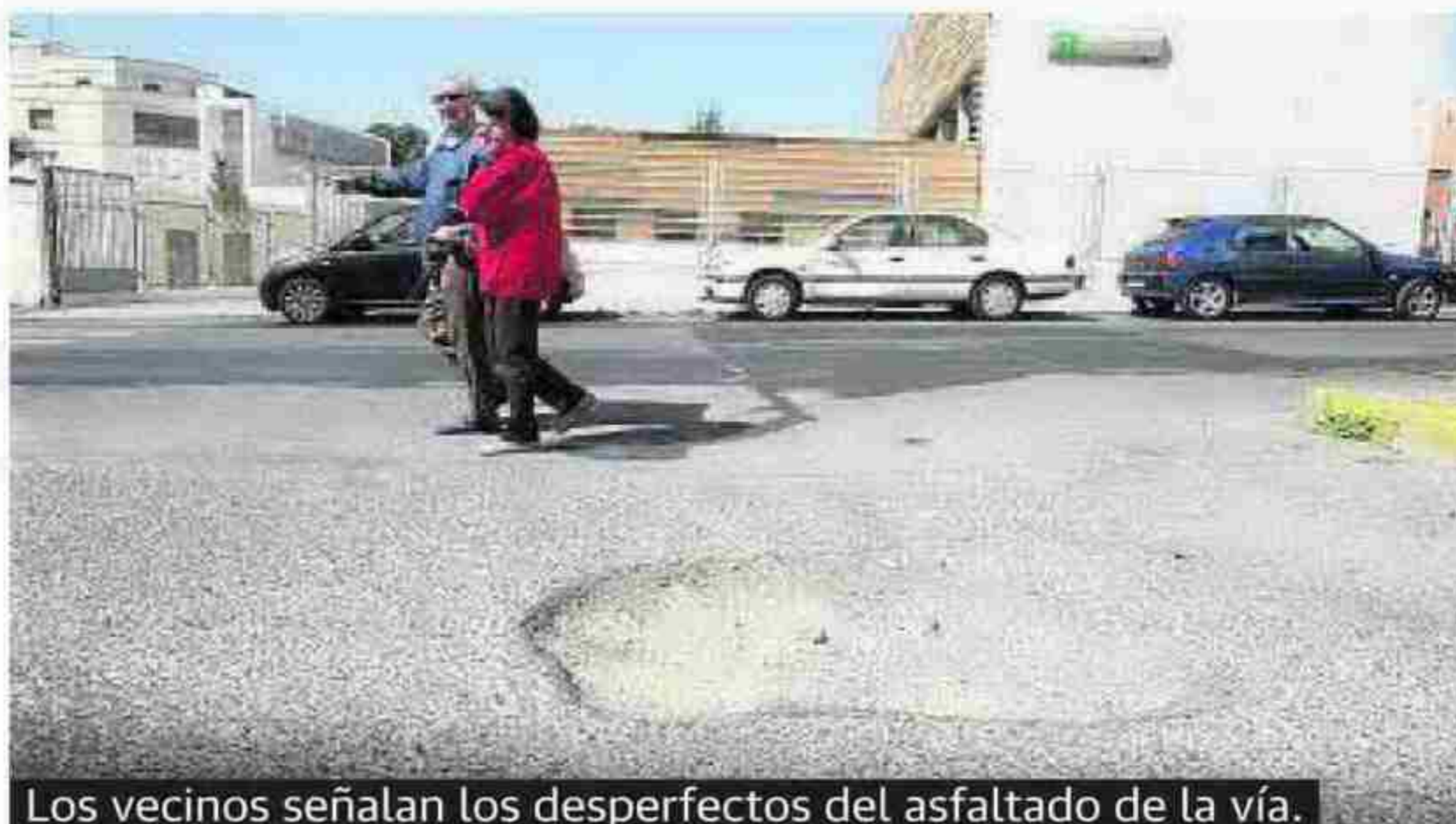
Los vecinos señalan los desperfectos del asfaltado de la vía.
