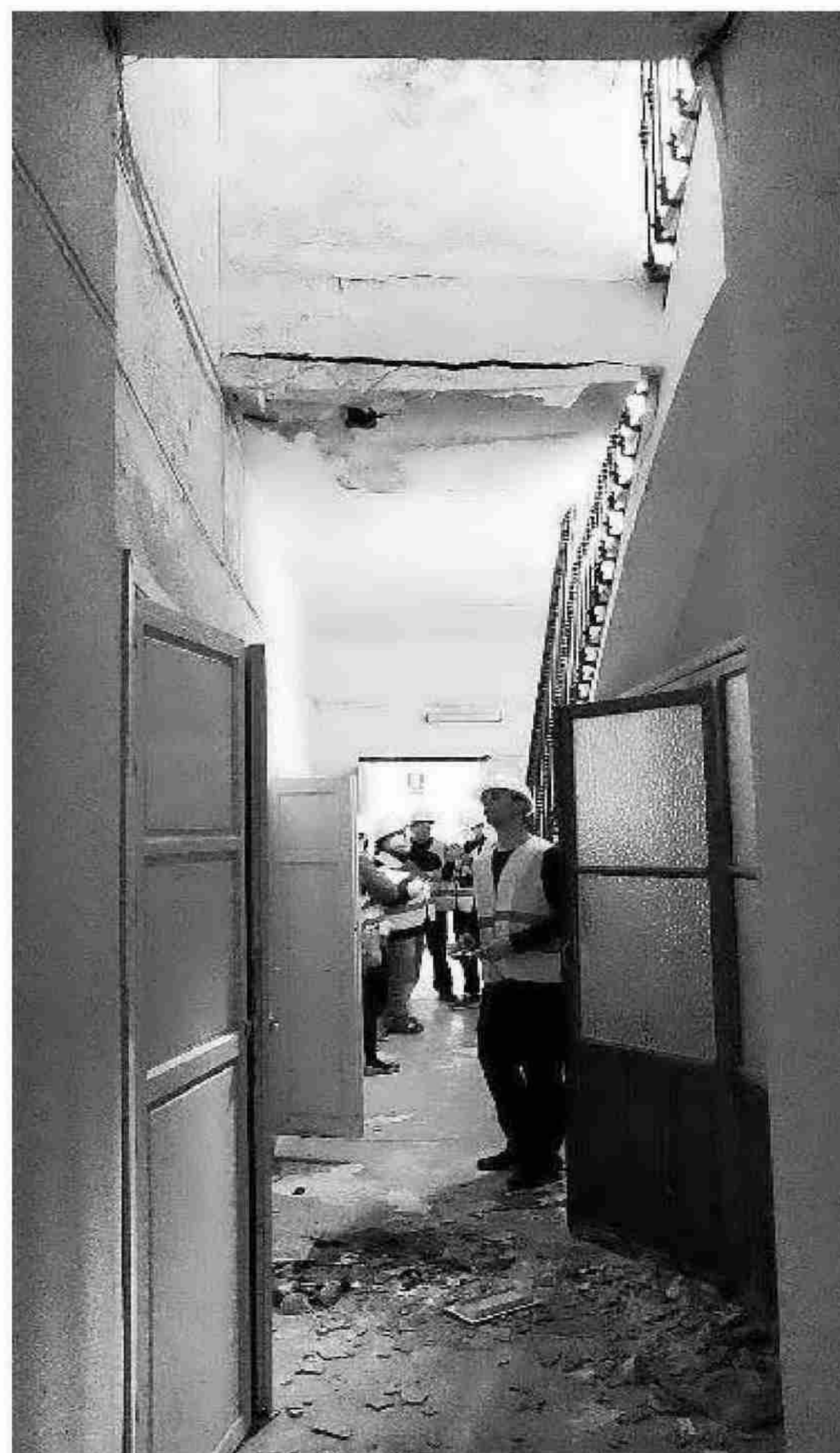
Estado de deterioro en el que se encuentra el Hospital Provincial. :: M. C.
