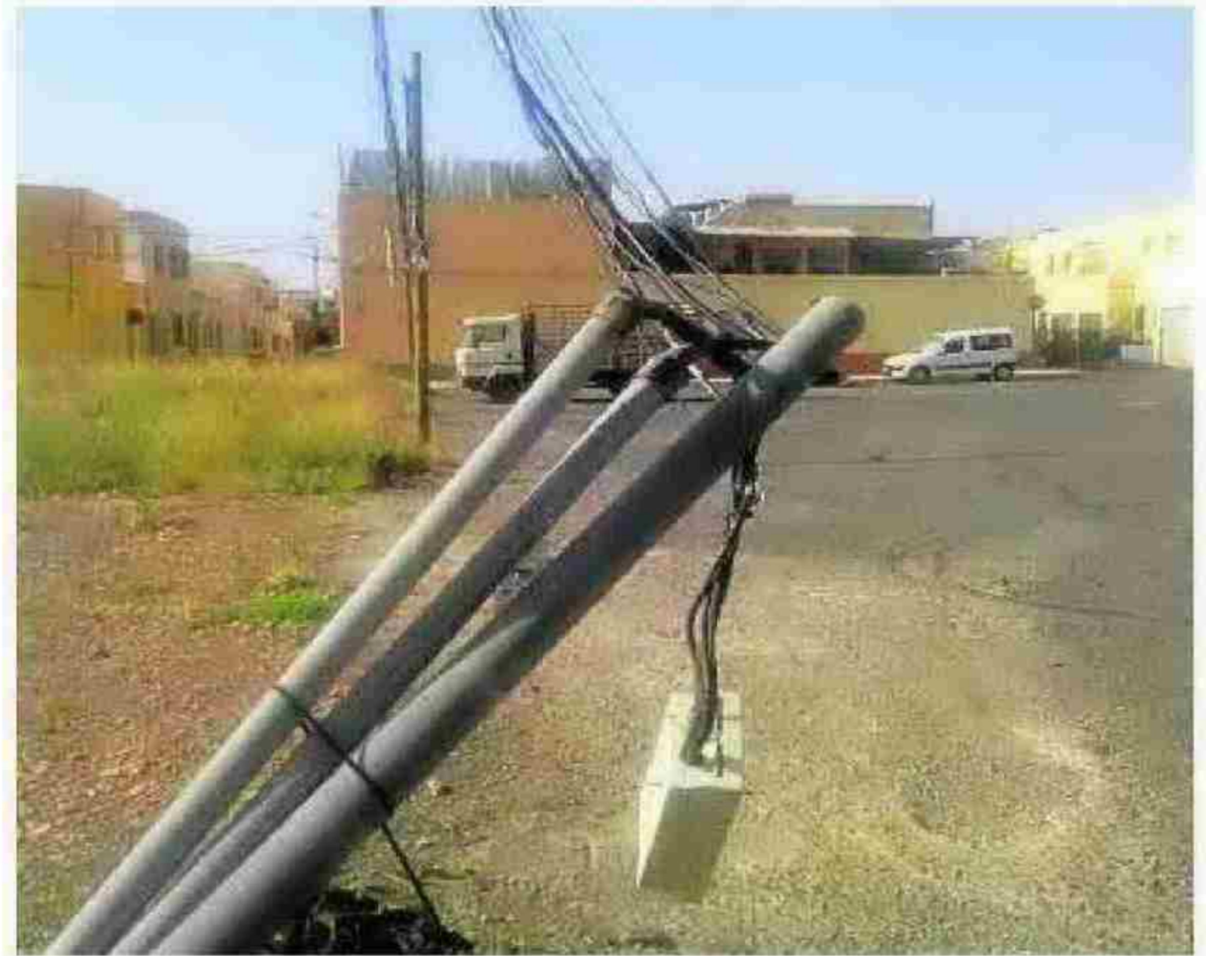
Este es el estado que presenta el cableado eléctrico en la zona. :: IDEAL
