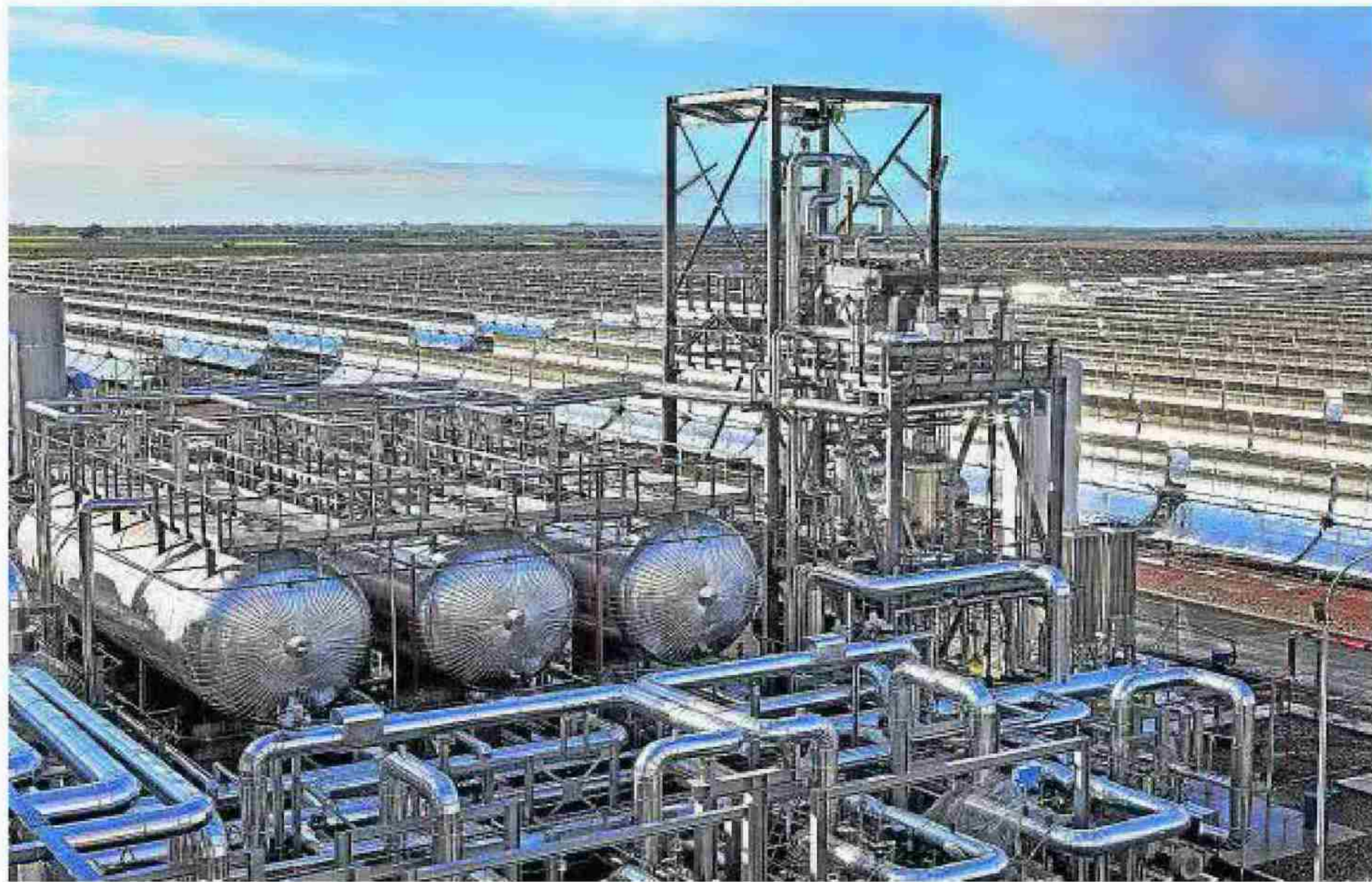
Vistas de Palma del Río I, planta solar termoeléctrica de Acciona Energía en Córdoba. :: ACCIONA ENERGÍA
