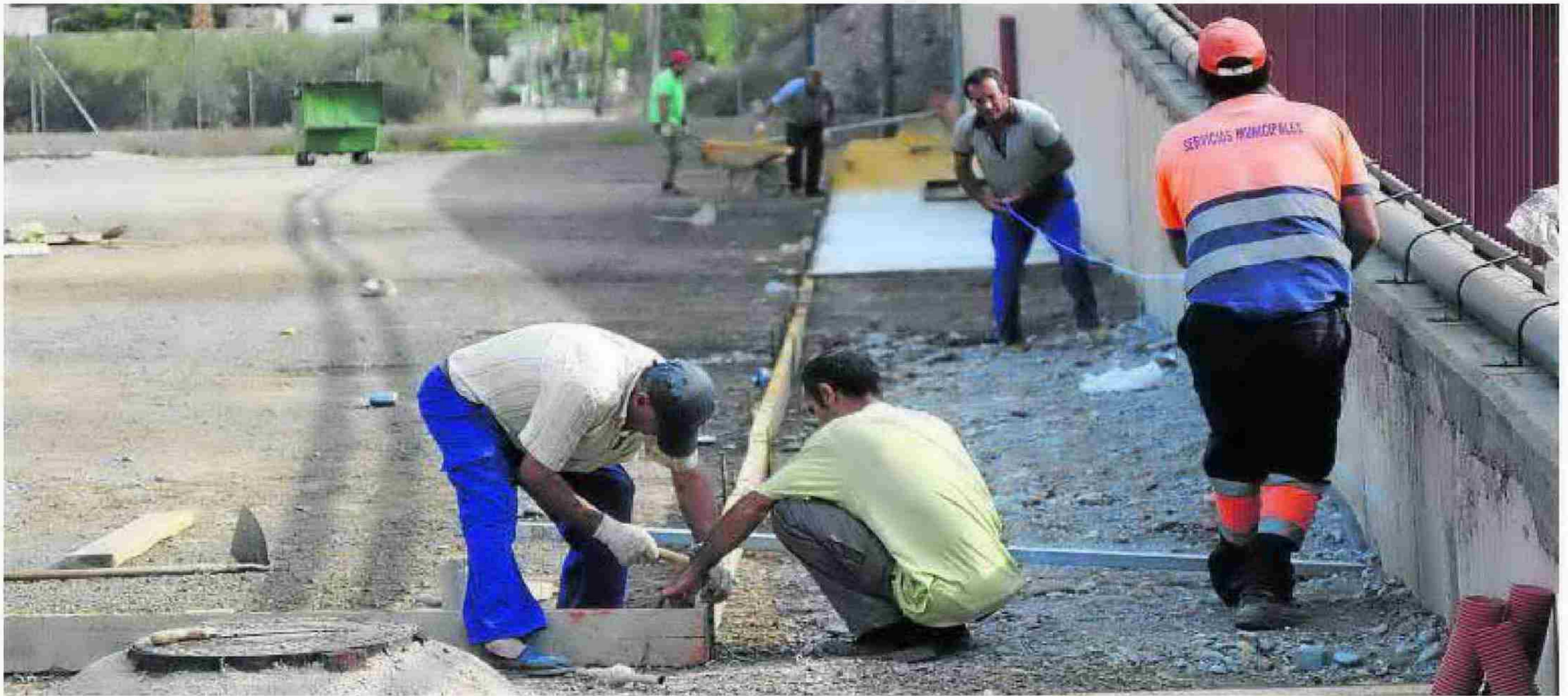
Empleados del PFEA, durante unas obras de urbanización en un espacio al aire libre de Gádor, en el Bajo Andarax. :: R. I.
