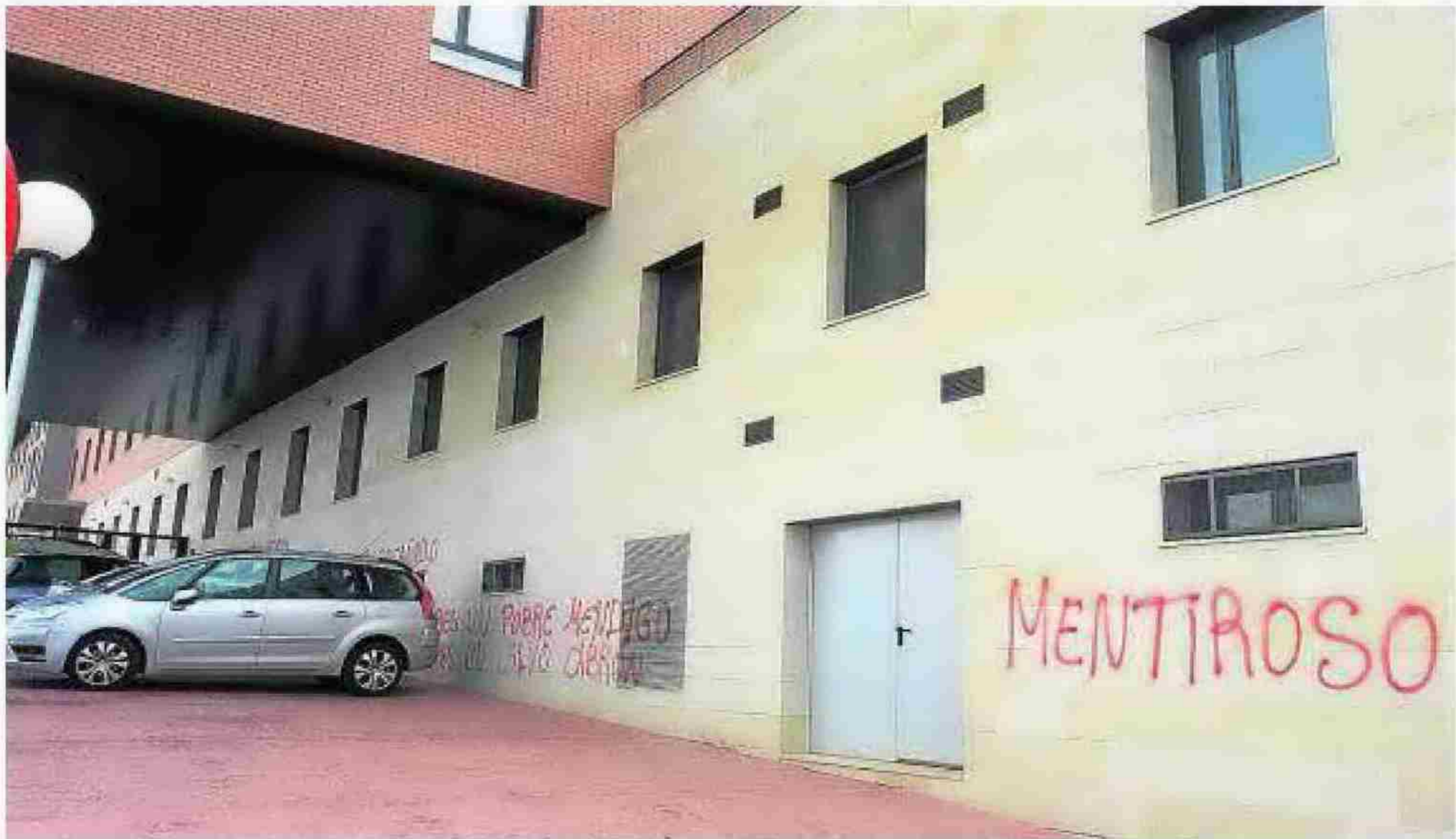
Estado de la fachada de la residencia el día después del planteamiento de un ERE. :: L. MONTALVO
