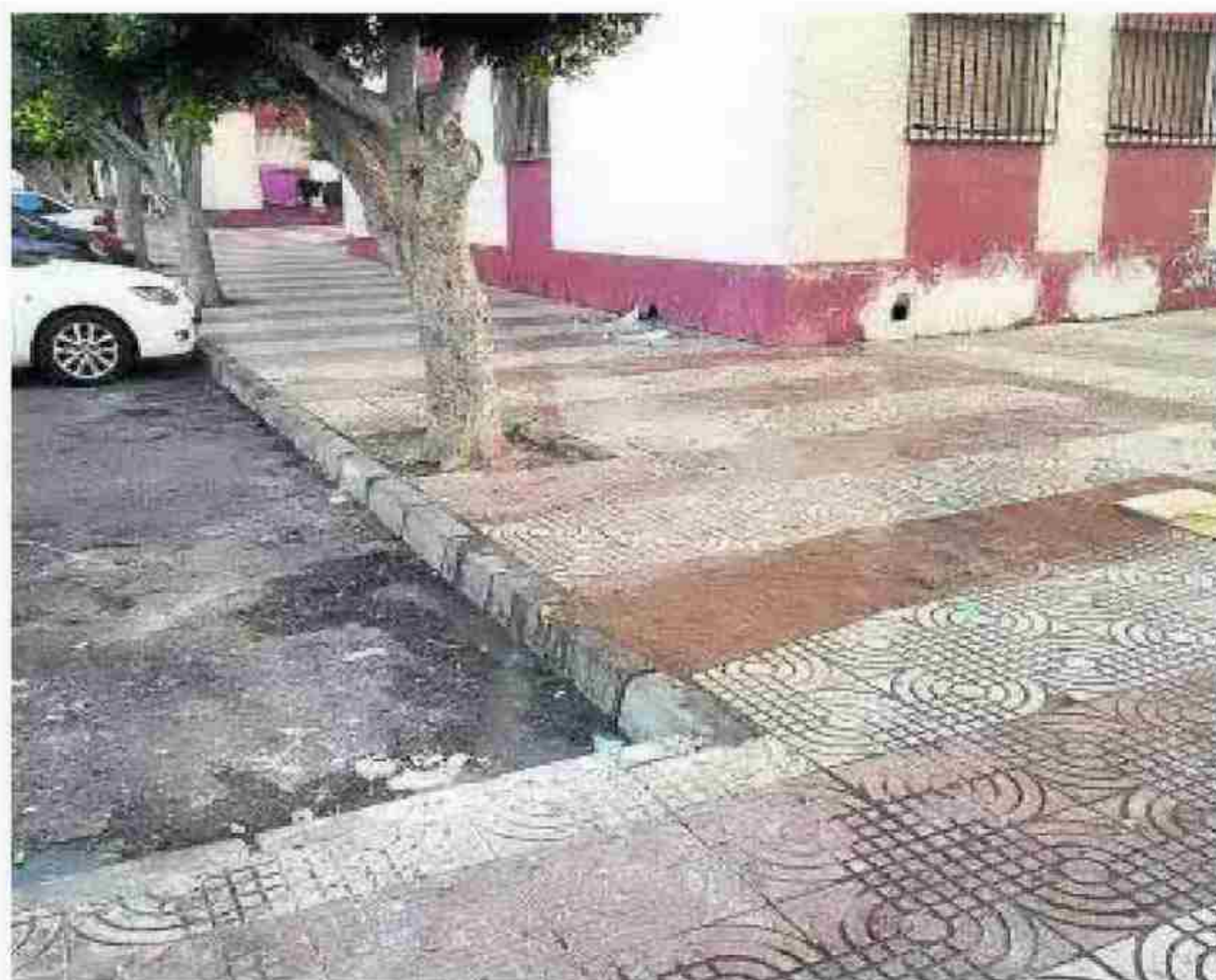
Aspecto que presentan los alrededores de los edificios afectados.
