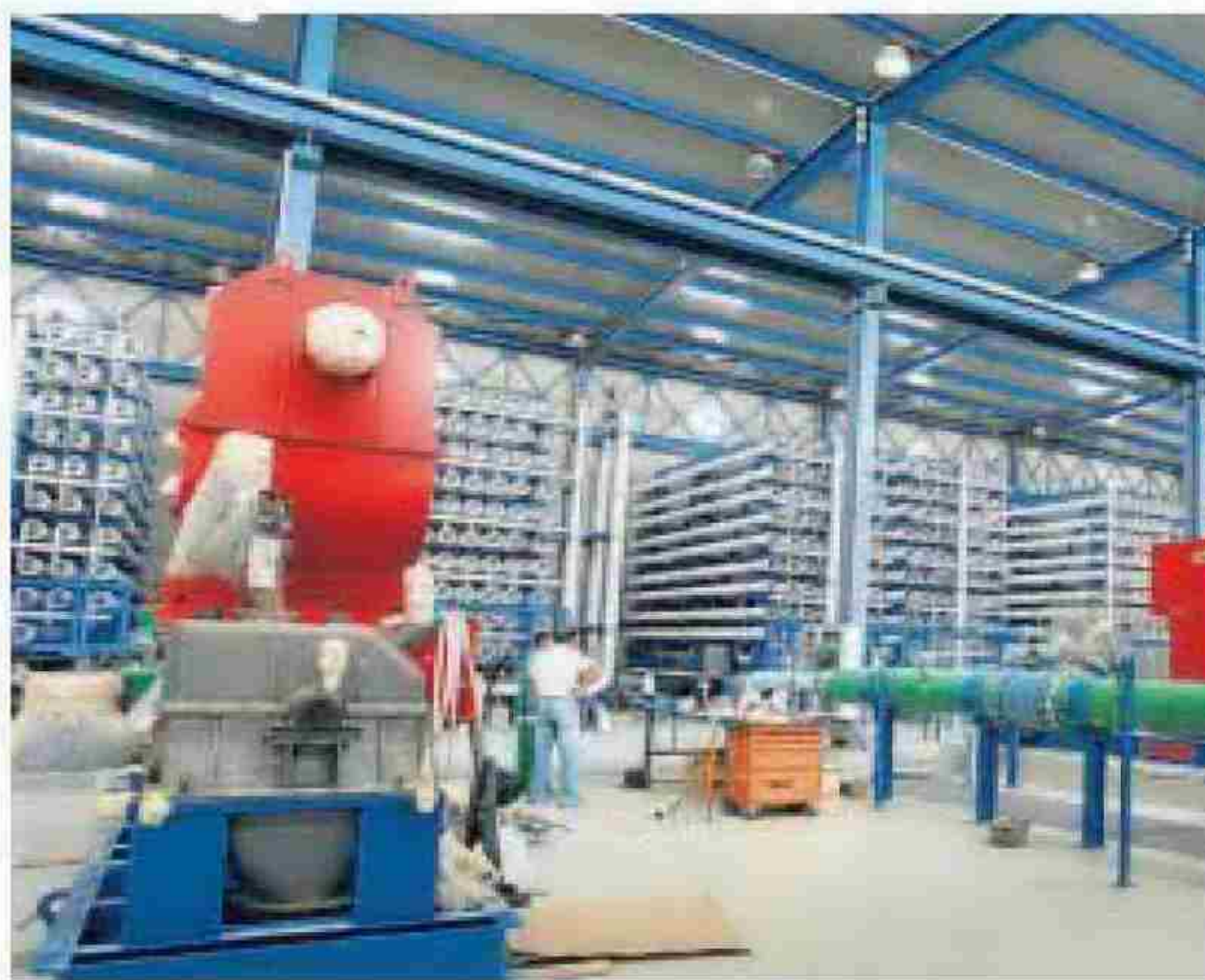
Interior de la desaladora que está totalmente parada.
