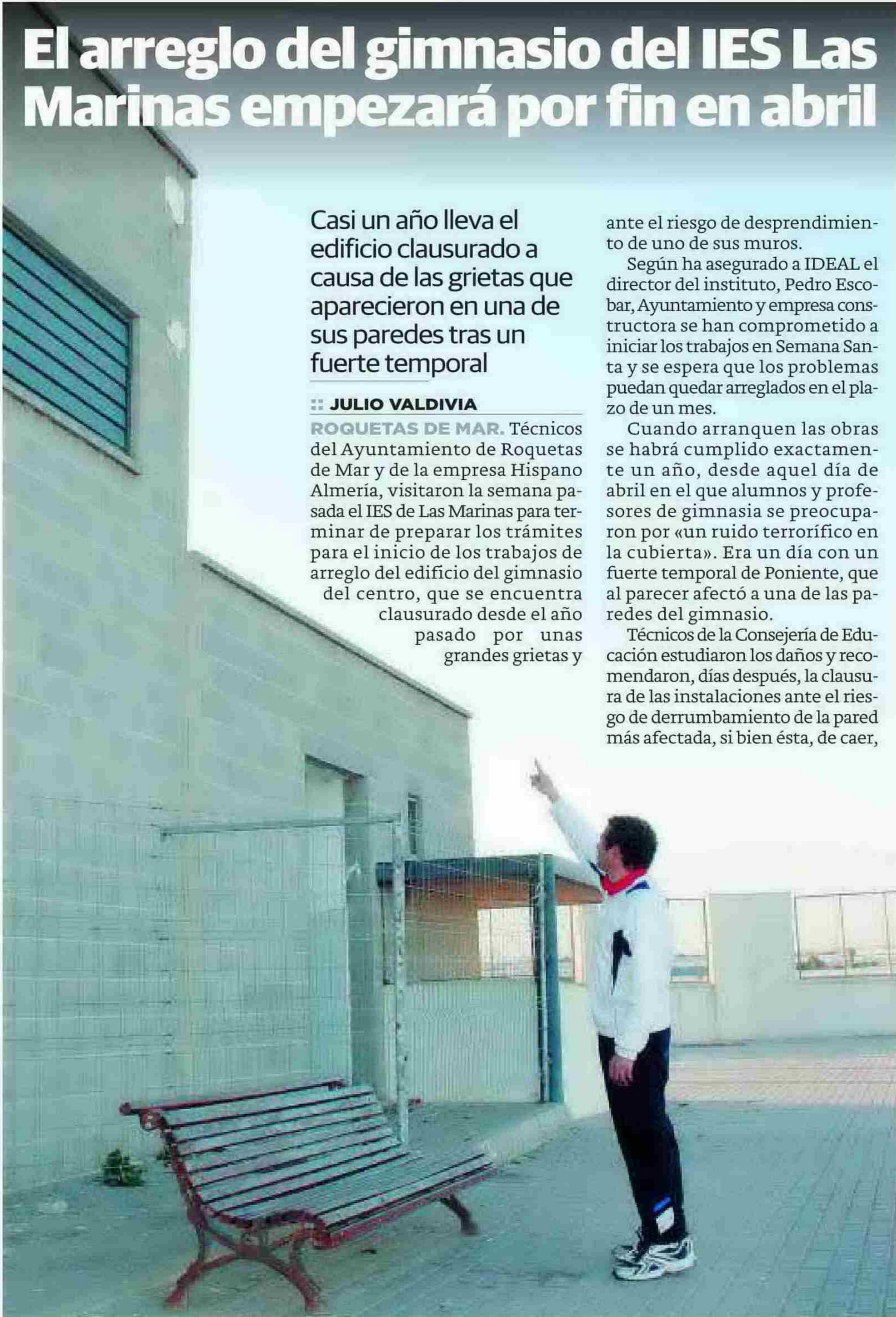
Una zona ha tenido que ser acordonada por riesgo de desprendimientos.
